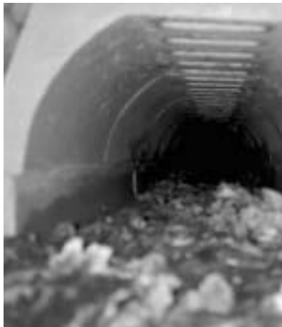
Dieser Tunnel führt die Frösche und Kröten unter der Kantonsstrasse durch zum Talweiher in Anwil (Foto: Claudia Buser)
