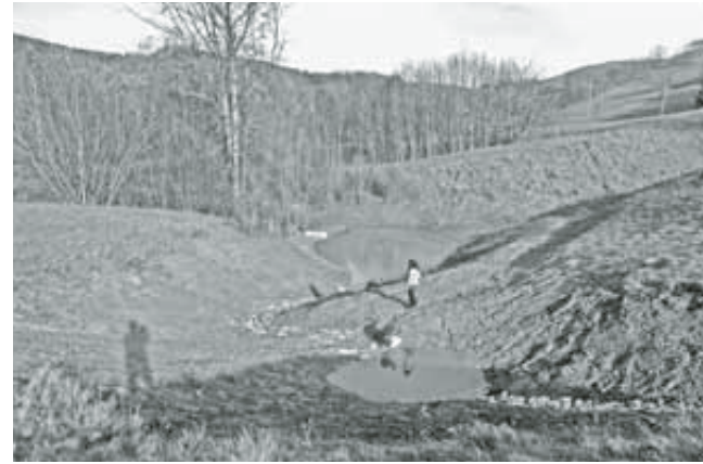
Ein weiteres erfolgreiches Projekt im Rahmen von gummistiefelfeld-bl: Die Ausdolung des Gruebetsmattbächlis auf der Schafmatt bei Oltingen mit der Anlage von 3 Weihern.
