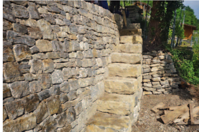
Am Dielenberg in Oberdorf wurde die zweite Etappe der Sanierung der Trockenmauern abgeschlossen. Unterstützt wird dieses Mehrjahresprojekt unter anderem vom Fonds Landschaft Schweiz und von der Walder Bachmann-Stiftung.
